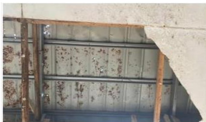
Gambar 2. Kondisi Plafon Memburuk
