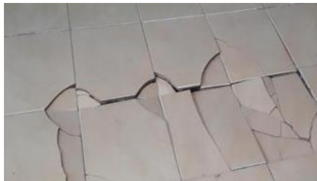
Gambar 1. Kondisi Lantai Memburuk
